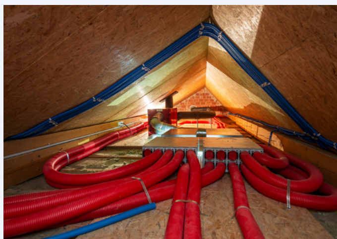
Technische Installationen für den Luftaustausch finden auch unter dem Dachgiebel Platz.
