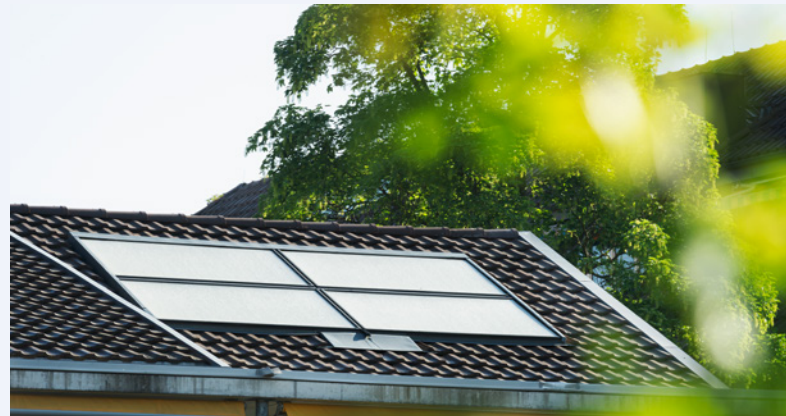
Solarkollektoren versorgen das Haus mit Warmwasser.
